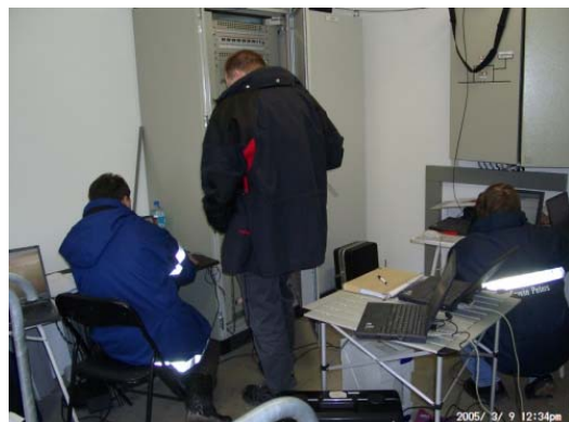
Inbetriebnahme mit Steuerung über 8 Notebooks
