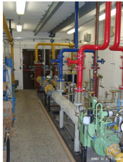
Regel- und Messanlagen auf Stahlkonstruktion, Anlage 2
