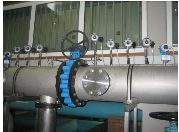
Manometeranordnung für Drucknotsteuerung
