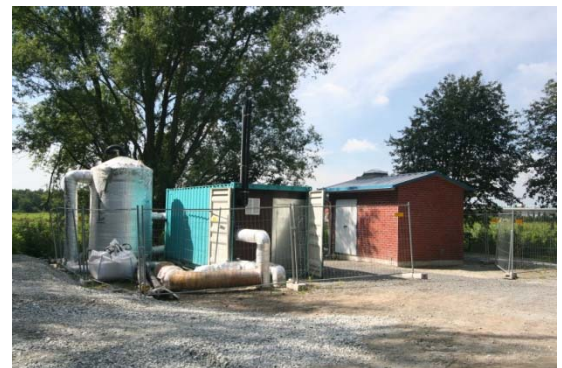
links: Entgasungsbehälter; Mitte: Container rechts: Brunnenstation
