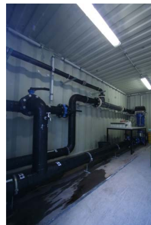
Belüftung des Rohwassers mit Wasserstrahlpumpe; hinten: Infiltrationspumpe; PVC-Verrohrung innen
