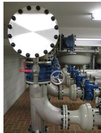
Rohrleitungen aus Edelstahl, Werkstoff 1.4571 Redundant aufgebaute Anlage
