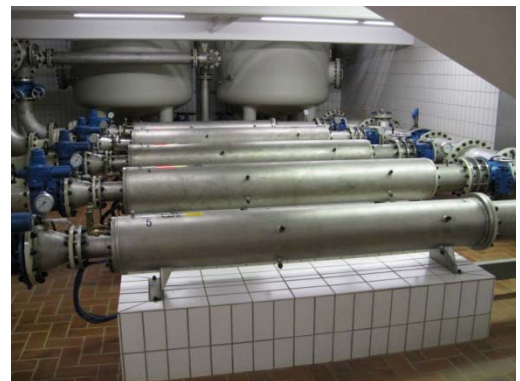
U-Pumpen im Druckmantel als Reinwasserpumpen
