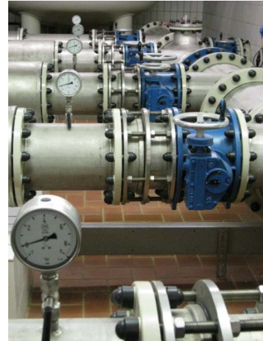
Saugseite der Pumpen mit Armaturen
