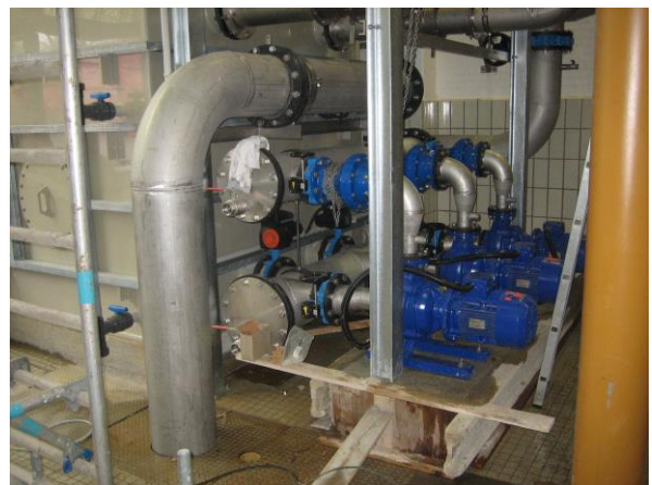
2 Doppel-Kaskaden und 3 Zwischenpumpen
