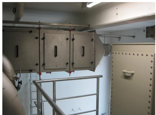
Filtereinheit Luftzufuhr und Reinigungsöffnung Kaskade
