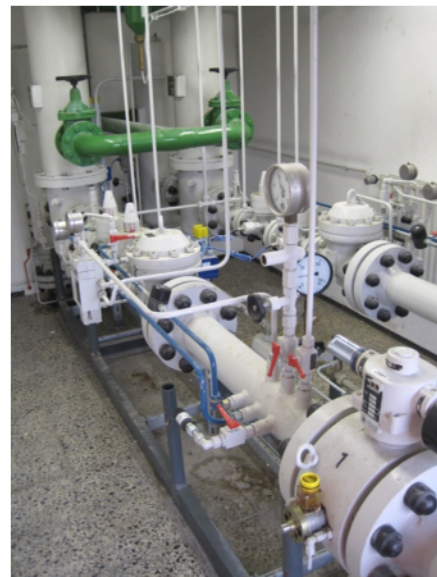
Regel- und Messanlagen, hinten: Filteranlagen
