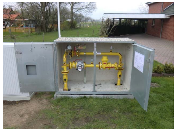
Netzkopplungspunkt Mitteldrucknetz 180 Nm 3 /h
