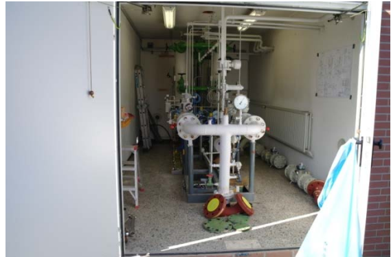
Umbau der Stationen im lfd. Betrieb; vorn: provisor. Anschluss zur Kopfstation der Pipeline
