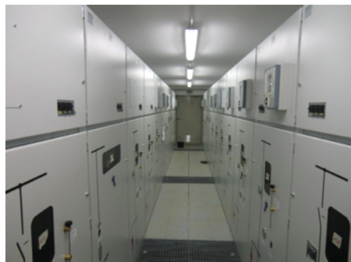
E-Schalt- und Messanlagen
